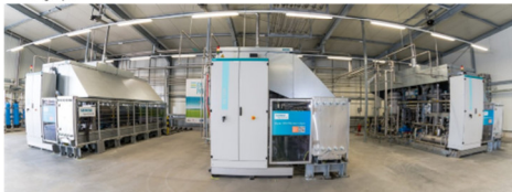
Das Bild veranschaulicht die Elektrolysehalle zur Wasserstofferzeugung im Energiepark Mainz.
